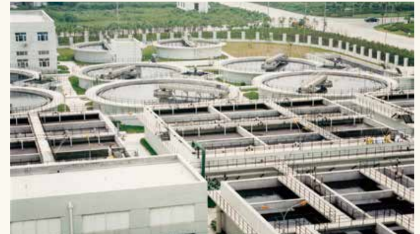
不断提升能效的污水处理设施。
